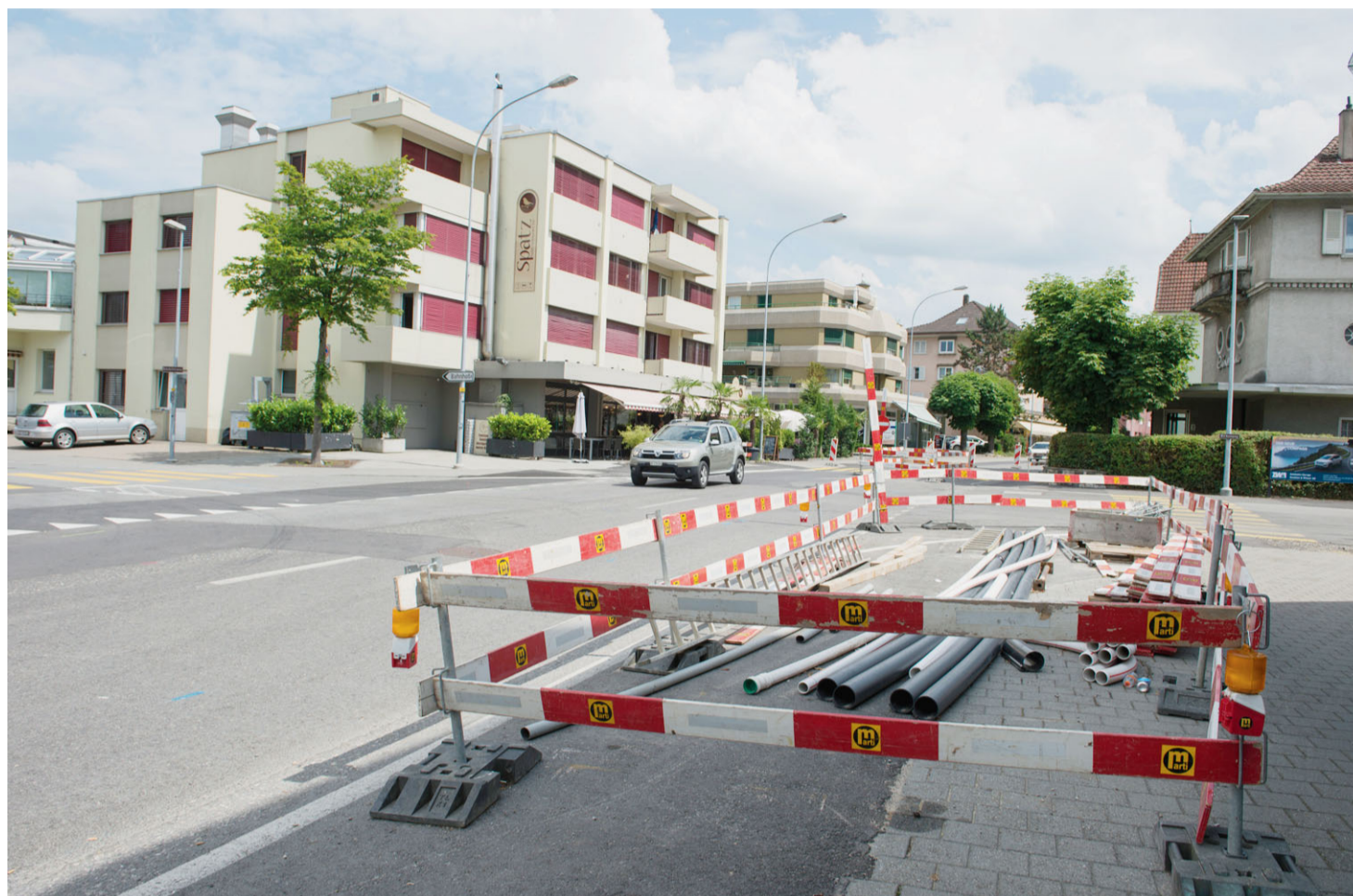
Die Werkleitungsarbeiten auf der Bielstrasse sind abgeschlossen. Diese haben einige Überraschungen geboten. Peter Samuel Jaggi
